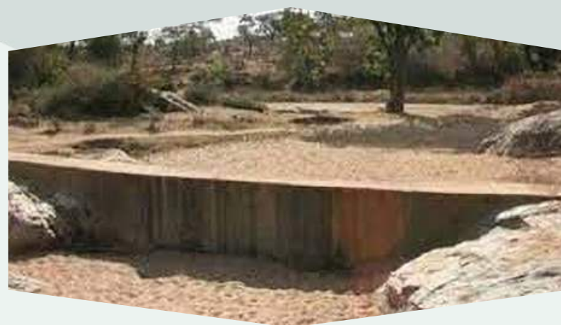
Presas secas. Fuente: Green Tec Irrigation
